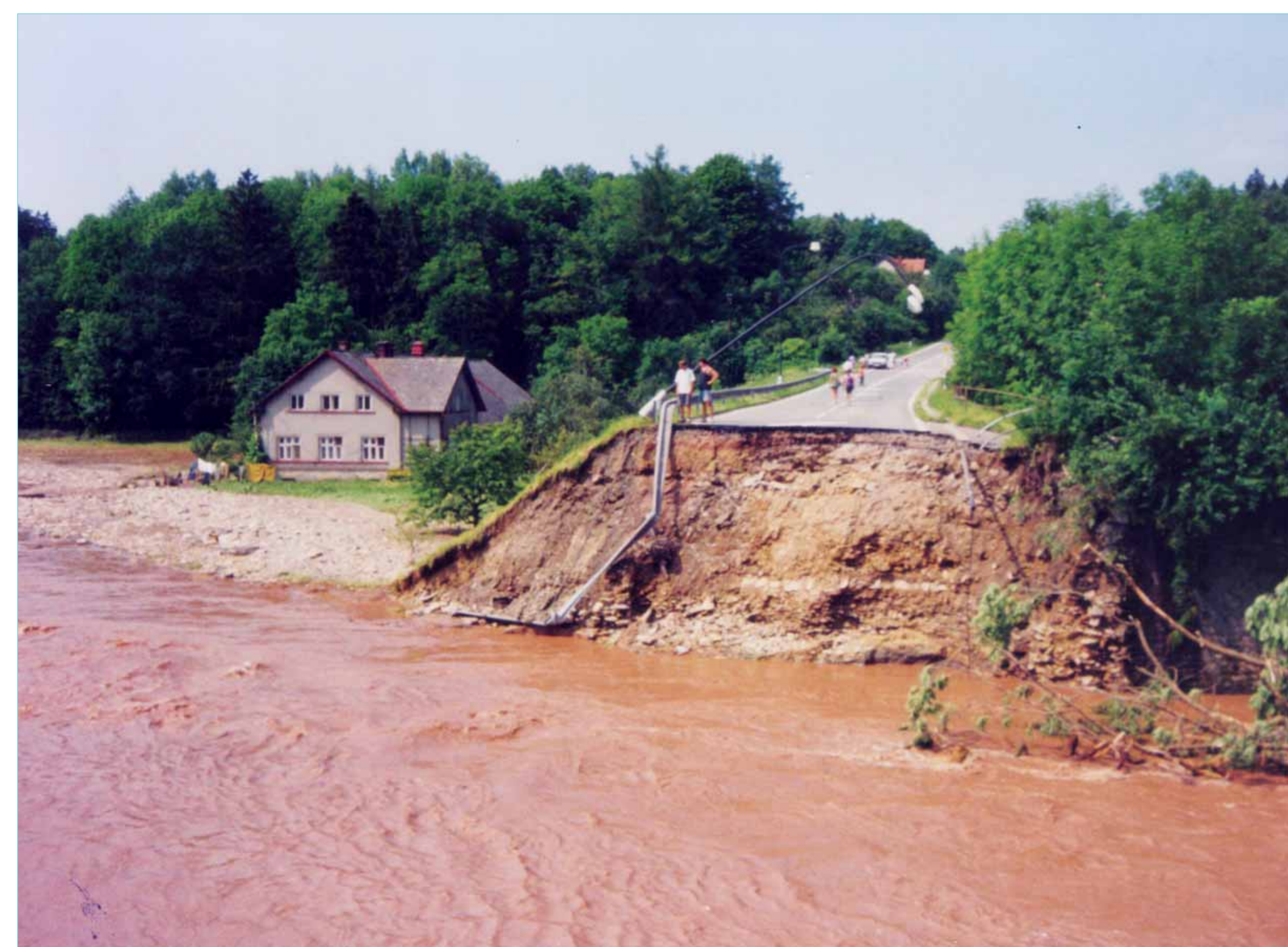
Stržený silniční most na říčce Dědině v Cháborech.
